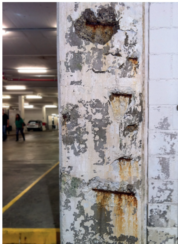
Corrosion due à la carbonatation du béton
