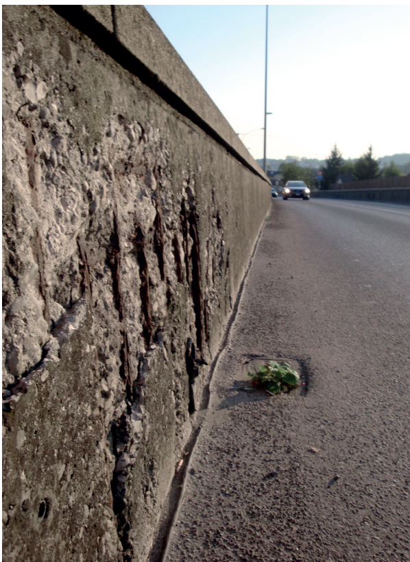
Corrosion due à l'action des chlorures
