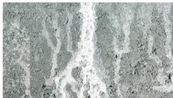
Neubeton mit starken Flecken
