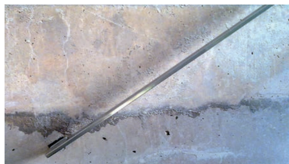
Neubeton mit Betonierfehlern, die nachgespachtelt werden müssen
