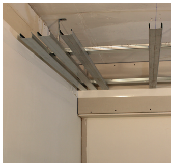
Création de la sous-structure, selon fiches techniques et esquisse/coupes de Knauf AG.
