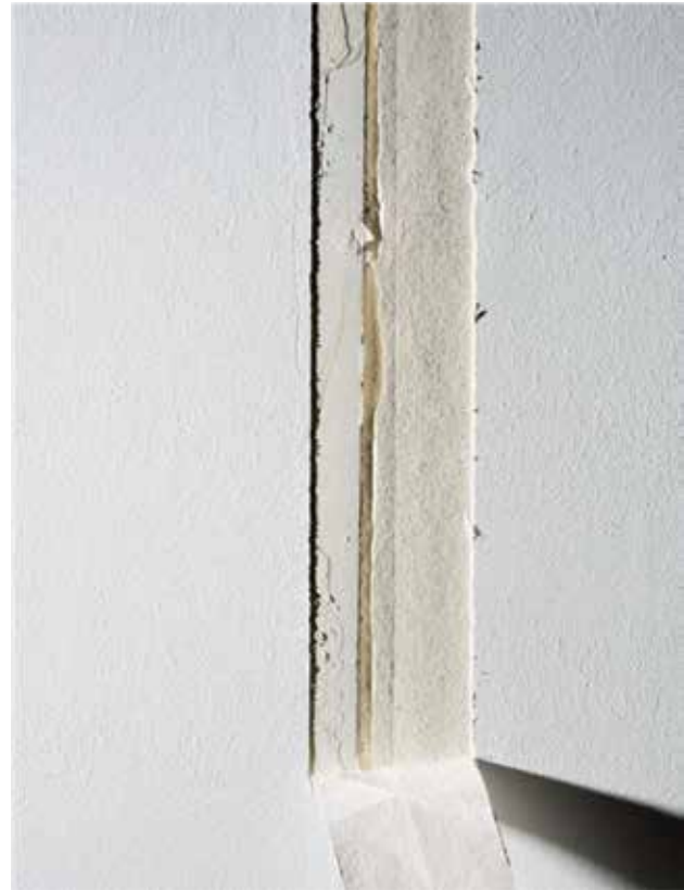
Ursache: zu wenig Spachtelmaterial unter dem Fugendeckstreifen auf der SK-Seite (links der Fugenmitte)
