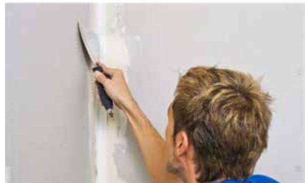
4. Mit Spachtel oder Träufel plan rechts und links des Falzes in die Spachtelmasse eindrücken.
