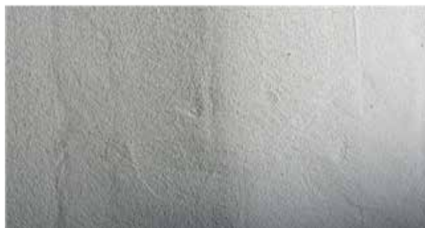
Erhöht gespachtelte Fuge bei viel Streiflicht
