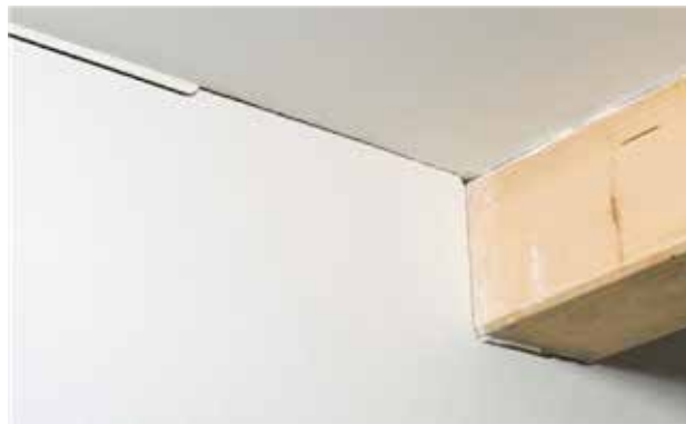
Überspringender Riss aufgrund fehlender Bauteiltrennung
