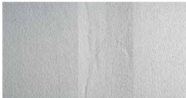
Vertieft gespachtelte Fuge bei starkem Streiflicht
