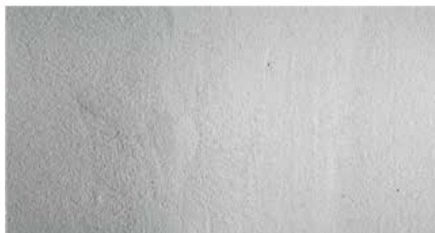
Erhöht gespachtelte Fuge bei wenig Streiflicht
