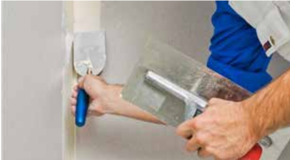
1. Masse mit Glättkelle oder Spachtel in die Fuge drücken. Auf beiden Seiten jeweils einen etwa 5 cm breiten und 1 mm dicken Film aus der Ecke heraus aufziehen.
