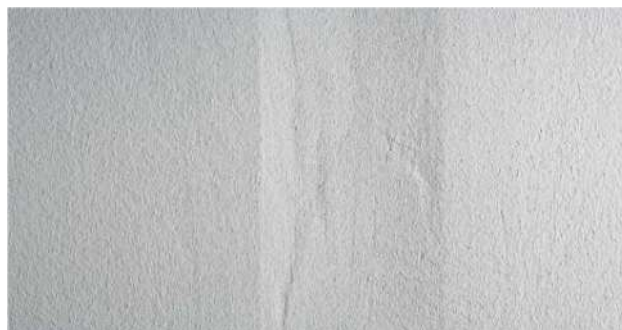
Giunto con stucco insufficiente, in presenza di forte luce radente
