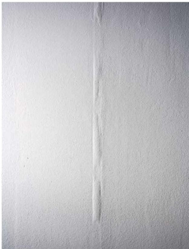
Formazione parziale di bolle, su un lato del nastro coprigiunto, dopo la tinteggiatura
