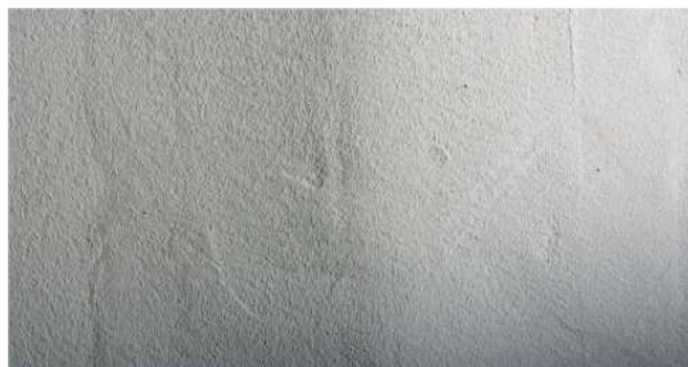
Giunto con stucco in eccesso, in presenza di forte luce radente
