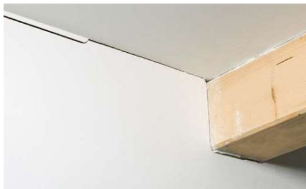
Crepa in rilievo dovuta alla mancata separazione degli elementi costruttivi.
