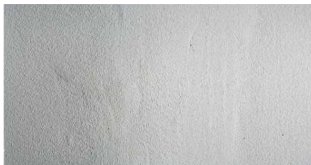
Giunto con stucco in eccesso, in presenza di scarsa luce radente
