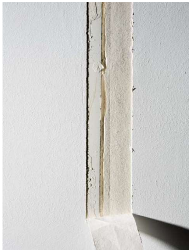
Causa: stucco insufficiente sotto il nastro coprigiunto sul lato SK (metà sinistra del giunto)
