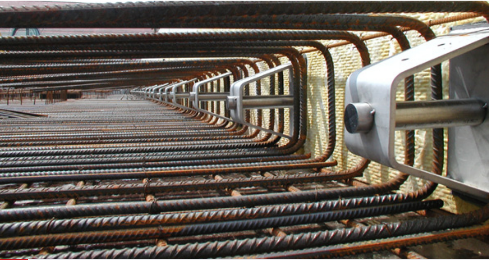
Egcodorn DNB fixiert im zweiten Betonierabschnitt vor Einbringung der inneren Lage ( A_{sy} ).
