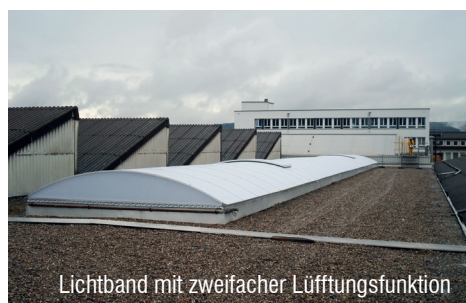
Lichtband mit Lüftungsflügel
