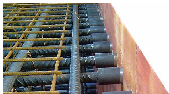
BARTEC® Schraubverbindungen in der Deckelplatte Halle Ost
