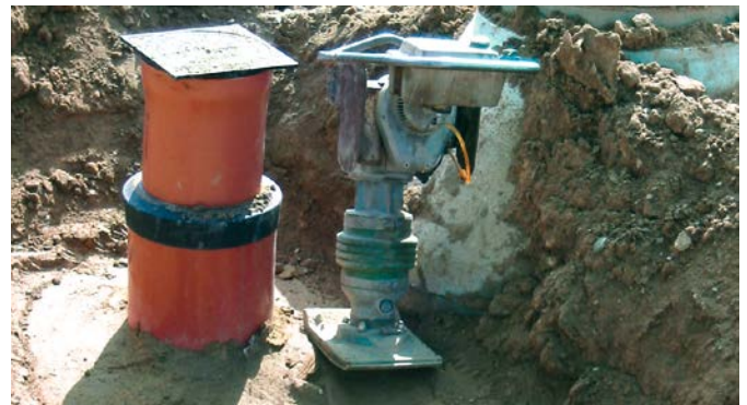
5 Einstecken der Teleskop-Abdeckung DN 315 in das Steigrohr DN 400. Anschliessend: lagenweises Einbringen und Verdichten des Einbettungsmaterials bis ca. 20 cm unterhalb der Oberkante Teleskop-Abdeckung.
