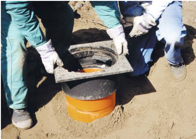
5 Lagenweises Einbringen und Verdichten des Einbettungsmaterials bis ca. 20 cm unterhalb der Oberkante Schachtverlängerung. Aufsetzen des Gussrahmens.
