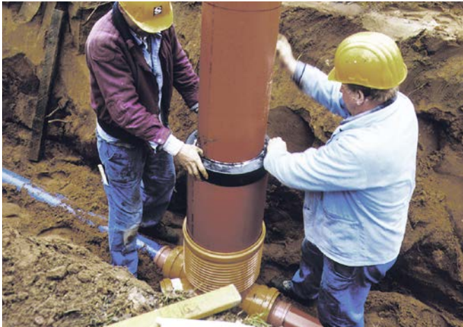
4 Aufsetzen der Teleskopmanschette und Einstecken des Teleskoprohres DN 315 in das Steigrohr DN 400.
