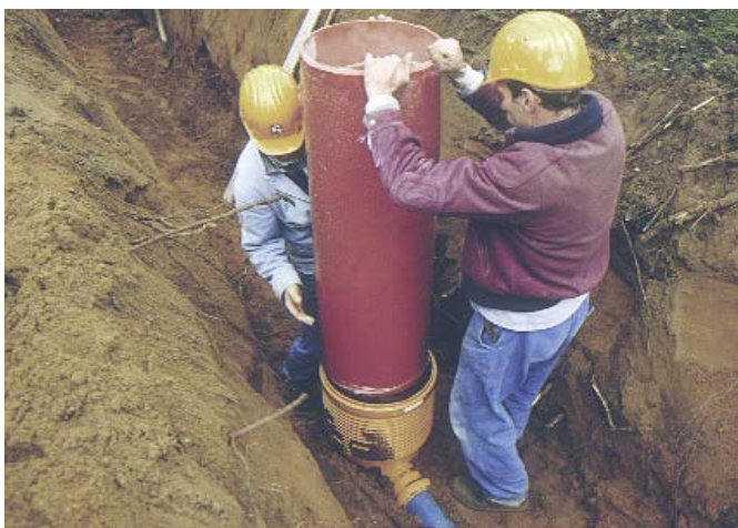
3 Einschieben des Steigrohrs DN 400 in den Schachtboden. Die weiteren Montageschritte sind von der gewählten Schachtabdeckung abhängig.
