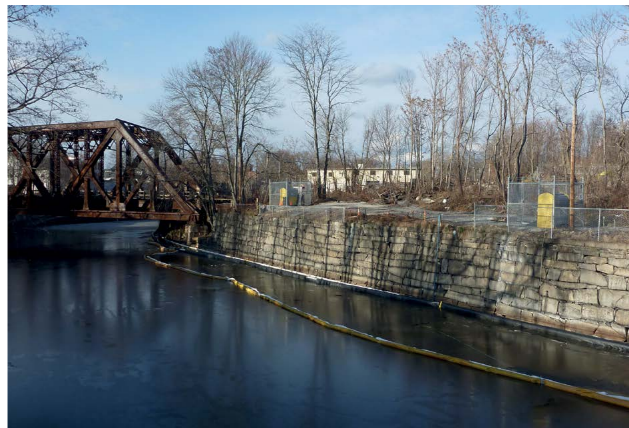
Rideau absorbant d'hydrocarbures sous l'eau
