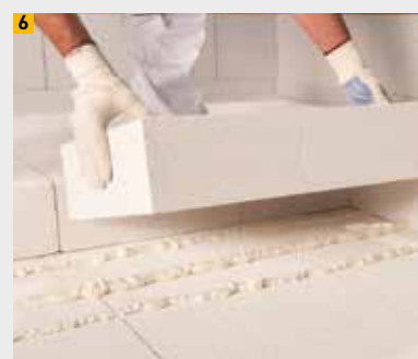
6 Installation de panneaux isolants en mousse adhésive isolante en PU, ici en tant que fixation pour le montage
