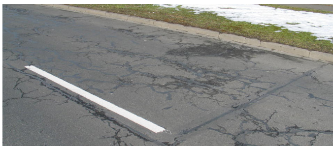
Dégradations avant réparation
